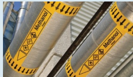
Marcado de Tuberías
