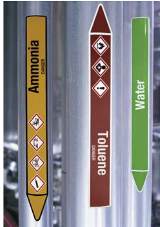
Marcado de tuberías
